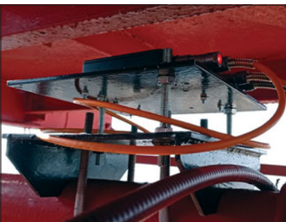
Рис. 2. Датчики, размещенные на распорке башни на отм. +180.000
